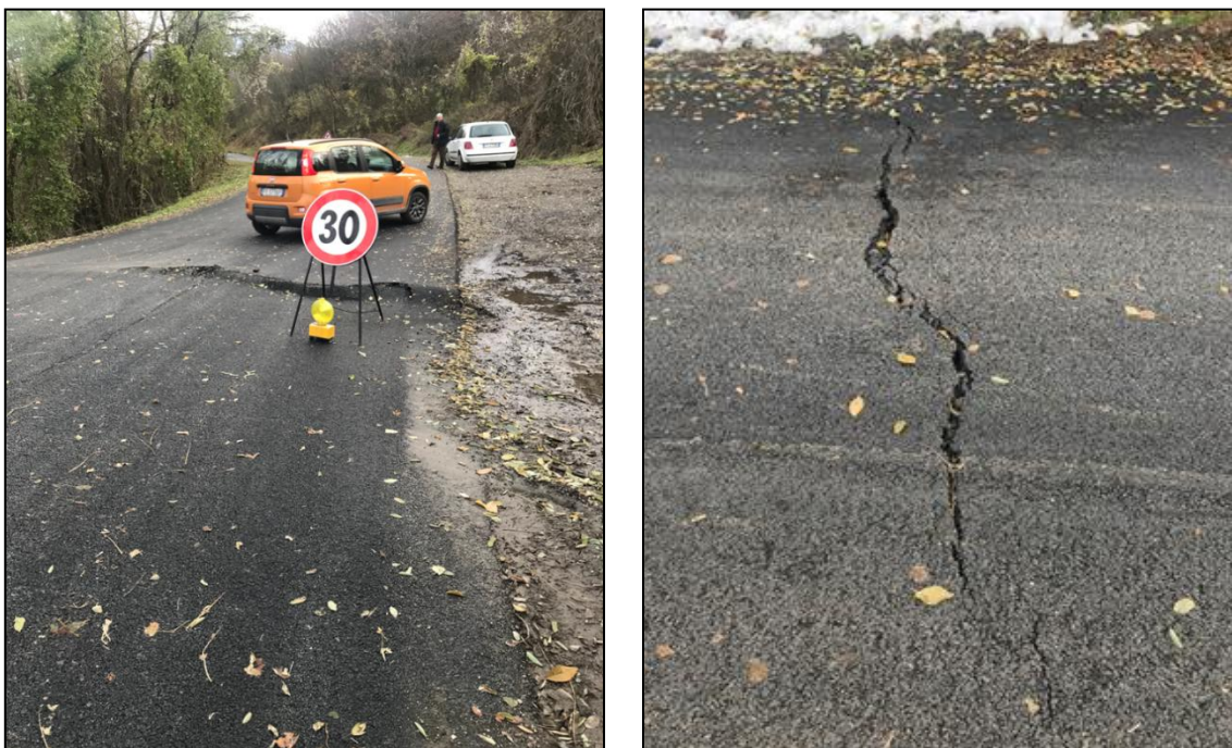
Figura 56: Segni della riattivazione della frana storica di Casale – Colla di Gambaro (foto Servizio Area Affluenti Po, ARSTePC).
