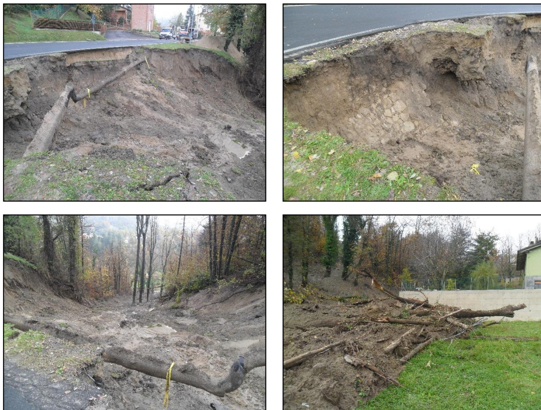
Figura 66: Alcune immagini del dissesto in via Napoleonica (foto Servizio Area Reno e Po di Volano, ARSTePC): nicchia che lambisce la via Napoleonica (alto a sx), dettaglio del vecchio muro di contenimento (in alto a dx), veduta da monte verso valle del corpo di frana (in basso a sx), deposito di frana in prossimità di un'abitazione nei pressi di via del Pozzo (in basso a dx)
