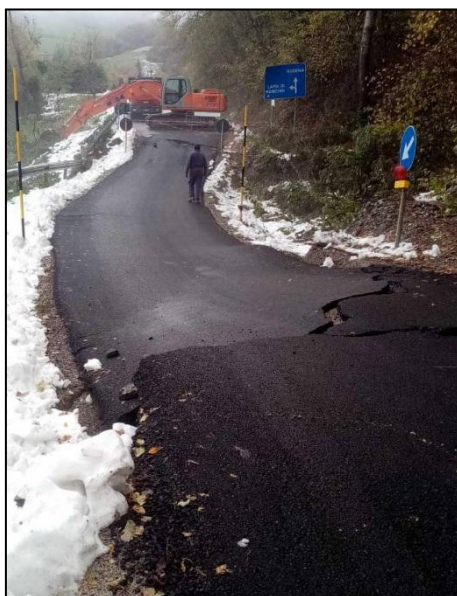
Figura 62: Cedimento della strada lungo la SP24 “di Monchio” (foto Resto del Carlino del 20/11).
