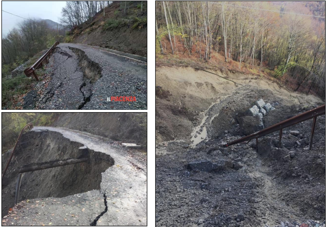
Figura 54: Frana sulla strada per Predalbora (foto tratte da ilpiacenza.it del 25/11 e liberta.it del 24/11). Nel confronto tra le due immagini di sinistra è evidente la evoluzione progressiva del fenomeno.
