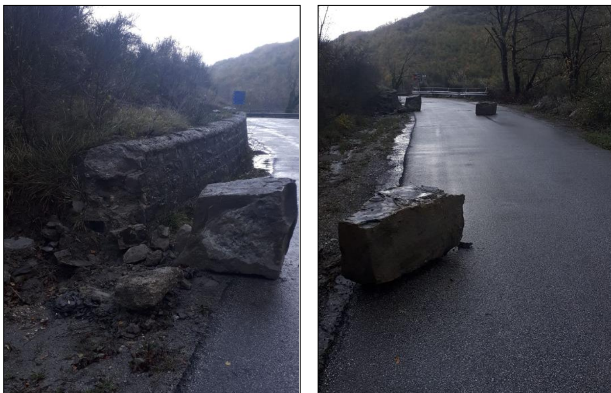
Figura 77: Crollo sulla SC “Ponte Pianerini – Villa Fragheto” (foto Servizio Area Romagna, ARSTePC).
