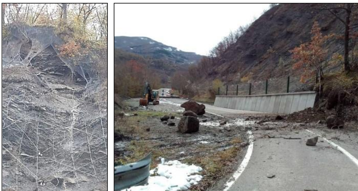
Figura 64: particolari della frana sulla SP486 “di Montefiorino” (foto Provincia di Modena e Agenzia Regionale per la Sicurezza del territorio e la Protezione civile).
