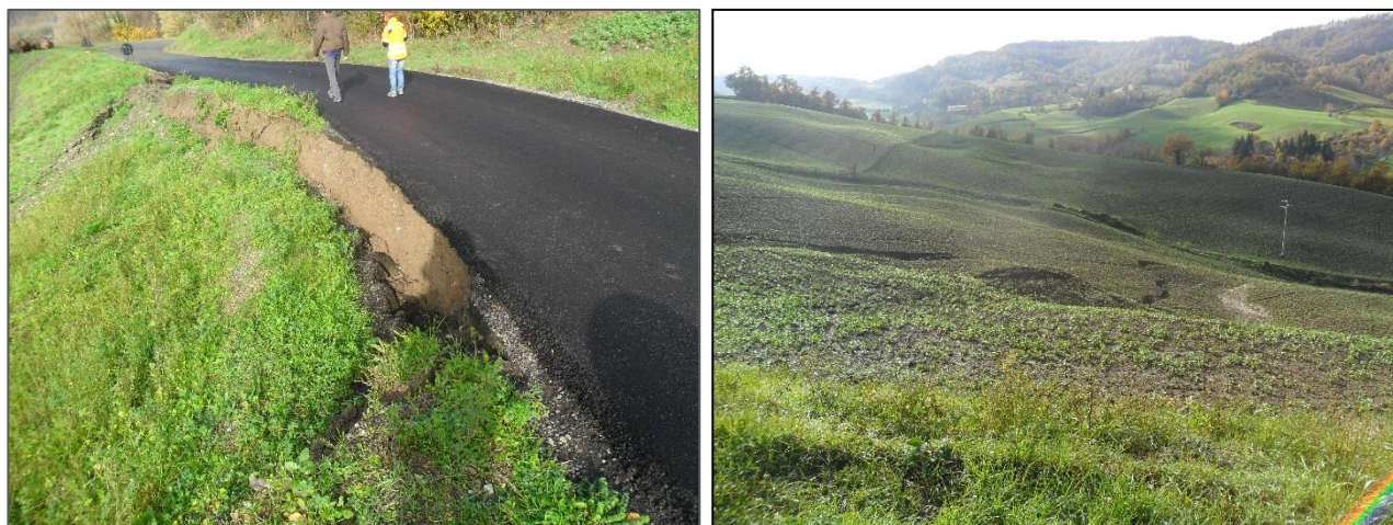
Figura 70: frana in via Roncastaldo (foto Servizio Area Reno e Po di Volano, ARSTePC).
