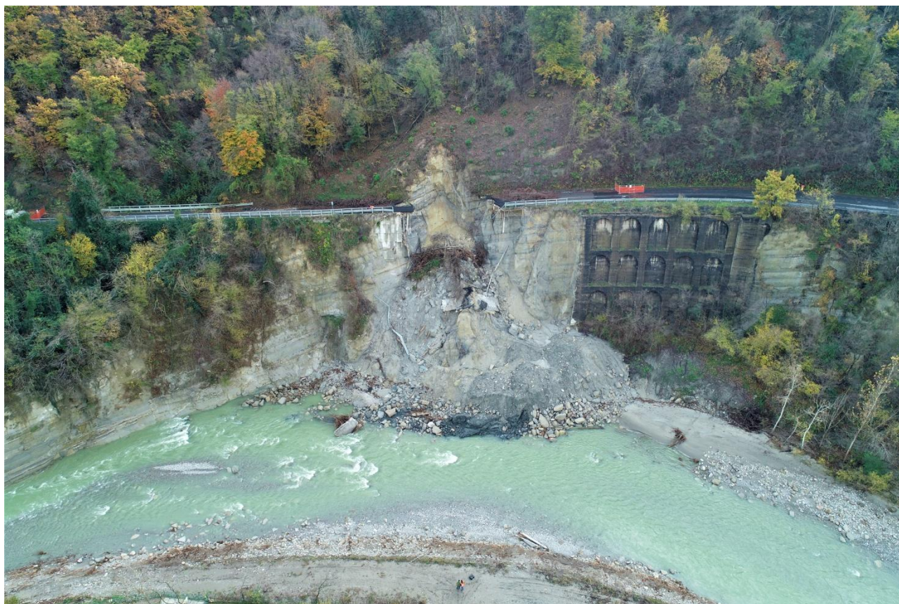
Figura 69: vedute della frana della Gardelletta, SP325 "Val di Setta" (foto Bologna Today e Servizio Area Reno e Po di Volano, ARSTePC).
