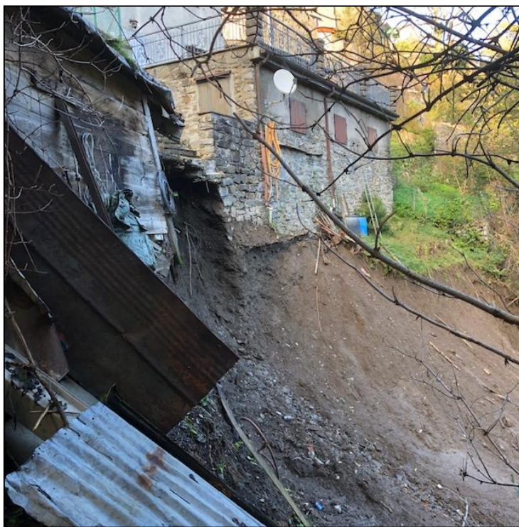
Figura 65: Dissesto a Montecuto delle Alpi (foto Servizio Area Reno e Po di Volano, ARSTePC).
