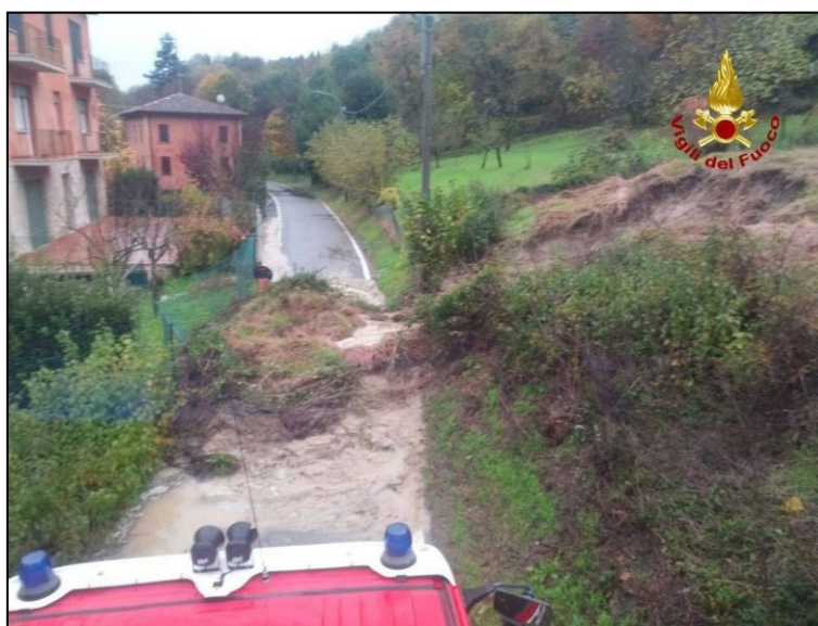
Figura 67: Frana in via del Ravone a Bologna (foto Vigili del Fuoco).
