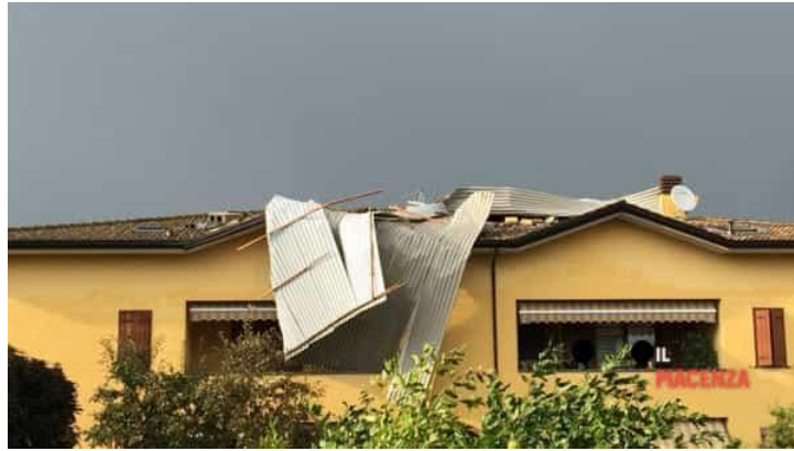
Figura 23. Danni a seguito delle raffiche di vento a Rottofreno (PC) (Fonte: www.ilpiacenza.it ).
