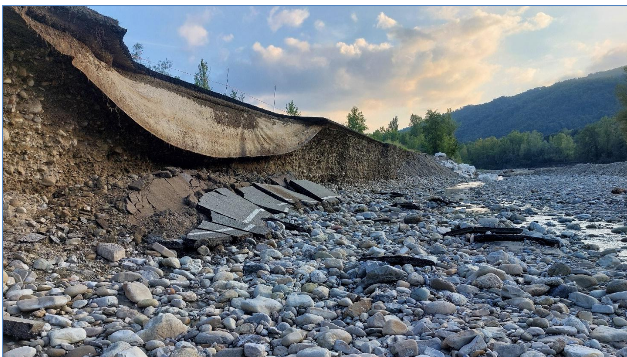
Figura 41: Erosione laterale del Torrente Savena, in Comune di Pianoro (BO).
