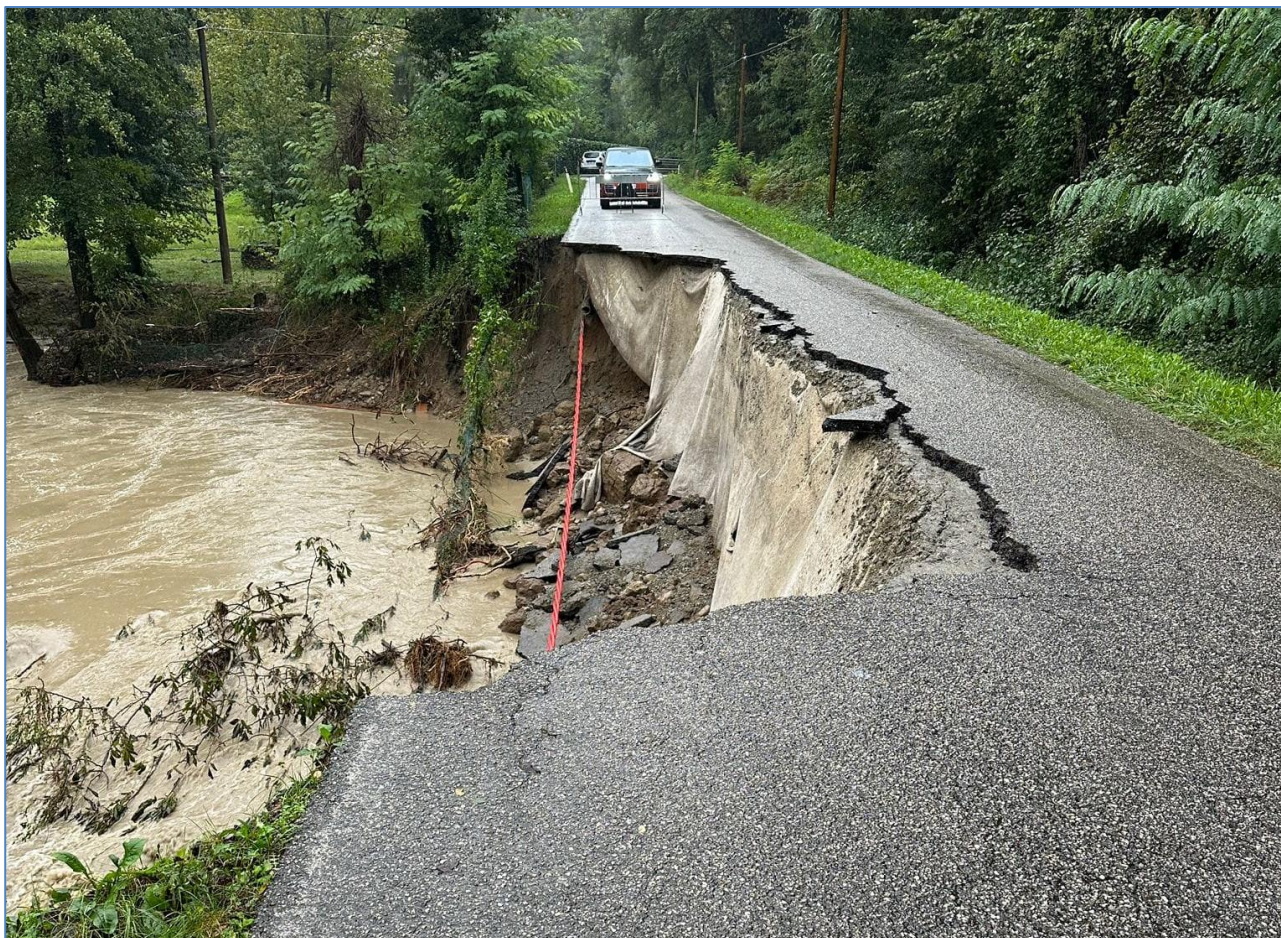
Figura 42: Effetto erosivo della piena del Torrente Zena, a monte della località omonima in Comune di Pianoro (BO).
