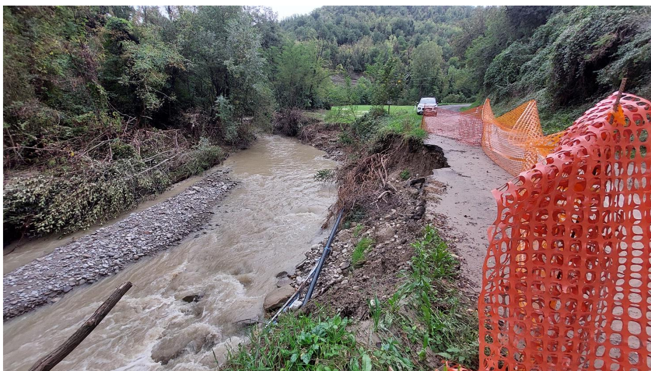
Figura 37: Effetto erosivo della piena del Torrente Zena, a valle della località omonima in Comune di Pianoro (BO).
