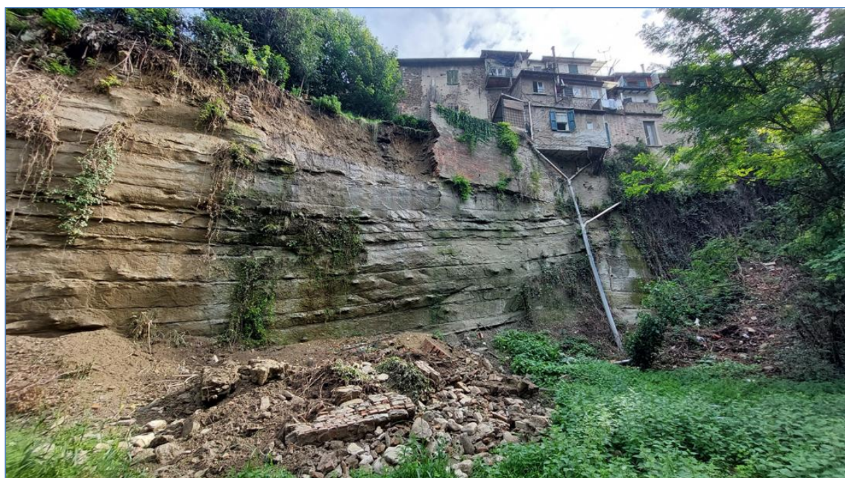
Figura 35: Crollo che ha interessato un costone roccioso nell'abitato di Fontanelice (BO).
