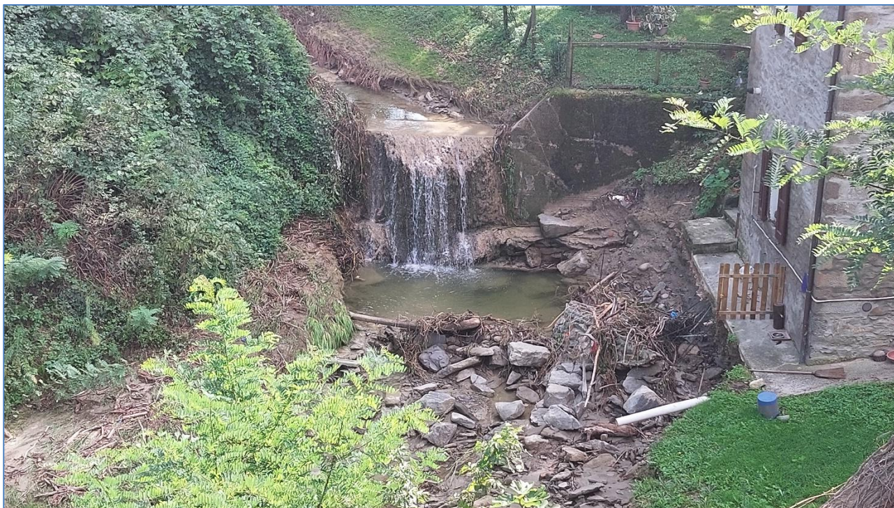
Figura 38: Effetto erosivo del Rio Chiusura (Comune di Fontanelice – BO) ai danni di edificio adiacente.
