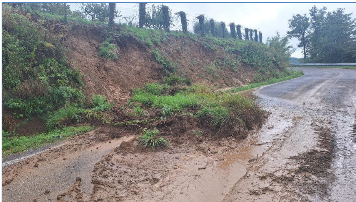
Figura 34:: Scivolamento di terra su strada in Comune di Modigliana (FC). Tali fenomeni si sono ripetuti decine di volte lungo la viabilità dei territori interessati dalle precipitazioni più intense.
