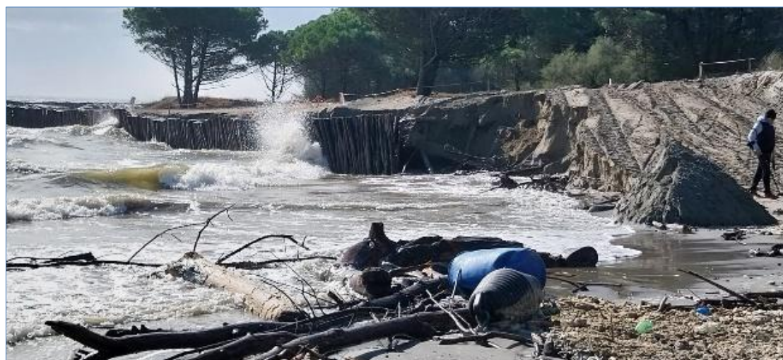
Figura 51: Erosione litorale con danneggiamento opera di difesa radente a Lido di Volano
