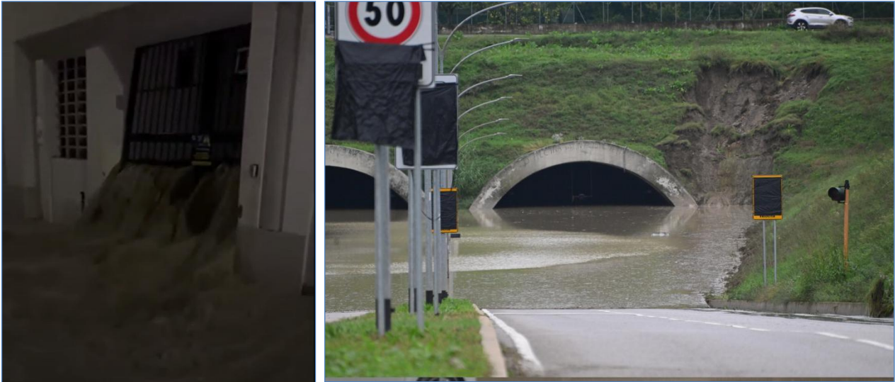
Figura 34: Allagamenti causati dall'esondazione del torrente Ravone a Bologna: rottura della tombatura in Via Brizio (a sinistra, foto QN) e riempimento del sottopasso di Via Sabena (a destra, foto Il Resto del Carlino)
