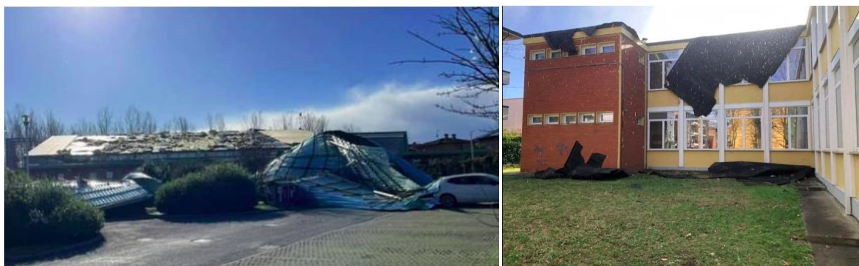
Figura 19: Danni nel Bolognese. Copertura della piscina a Ozzano divelta, a sinistra, tetto danneggiato in una scuola a Pianoro, a destra (fonte Il Resto del Carlino).
